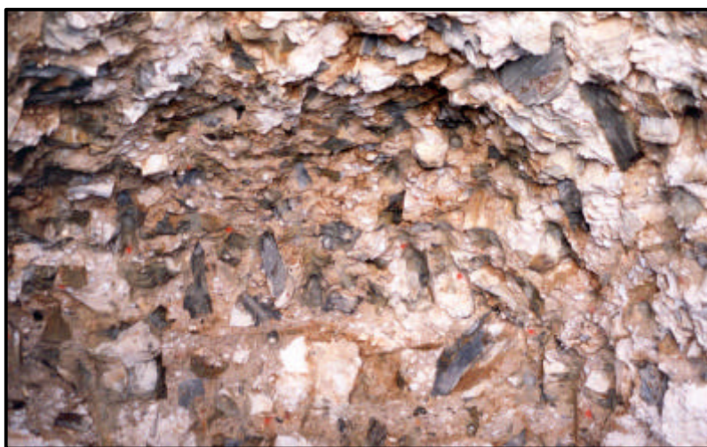
Figura 3. Estado actual del hormigón de la presa del Águeda en una galería abierta recientemente.
