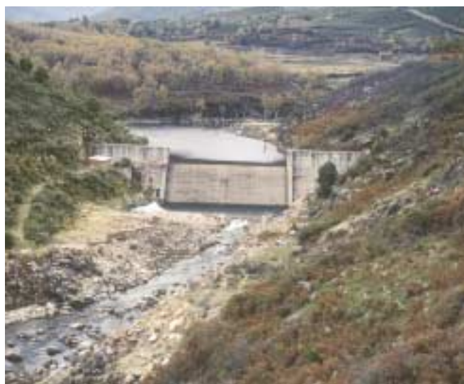
Fig. 4. Erosión provocada aguas abajo en el embalse de Minchones.
